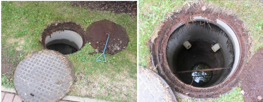
Kuvat 33 a ja b. Salaojaverkoston tarkastuskaivon pohjalla havaittiin vettä. Tarkastuskaivon kannesta vesipintaan on noin 1450 mm ja salaojaputkien yläpintaan noin 1250 mm.
