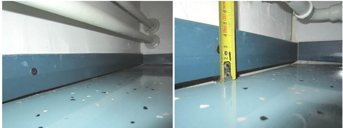
Kuvat 6 a ja b. Lattian ja seinän liitoskohdassa on rakoja mm. tiloissa D102, D103 ja D104.
