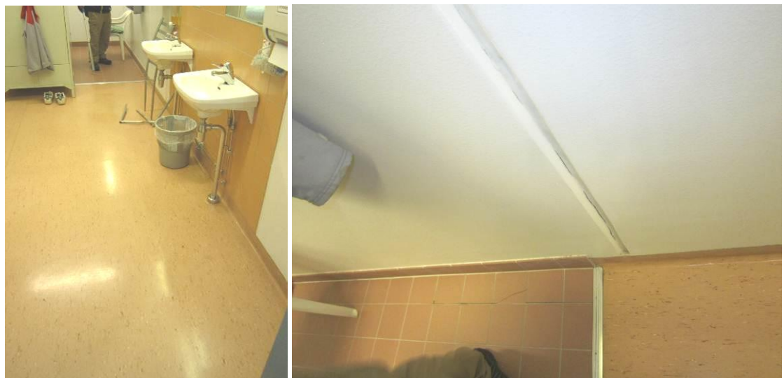
Kuvat 7 a ja b. Pukuhuoneessa D121 lattianpäällyste on osittain vaihdettu keraamisen laatoitukseen. Lattianrajassa havaittiin halkeamia lattian ja seinän liitoskohdassa, lattialaatoituksessa sekä seinien saumoissa.
