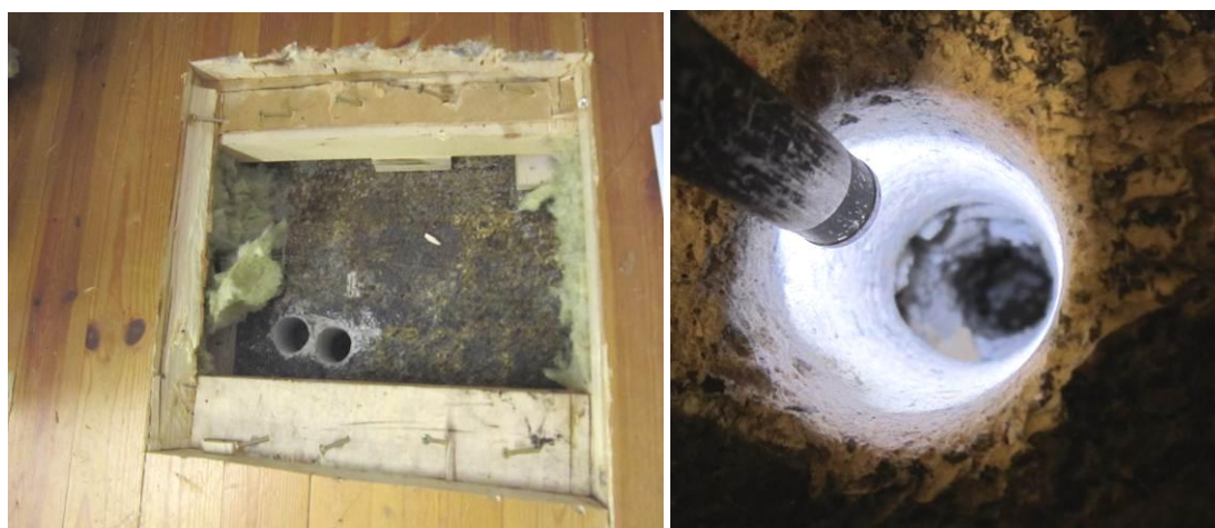
Kuvat 3 a ja b. Puutyösalin lattian rakenneavaus D1.2. Oikealla on lähikuva betonilaatan läpi poratusta reiästä, jossa näkyy solupolystyreeni-lämmöneriste. Materiaalinäytteessä D1.1, mineraalivilla, ei analysoitu mikrobikasvua.
