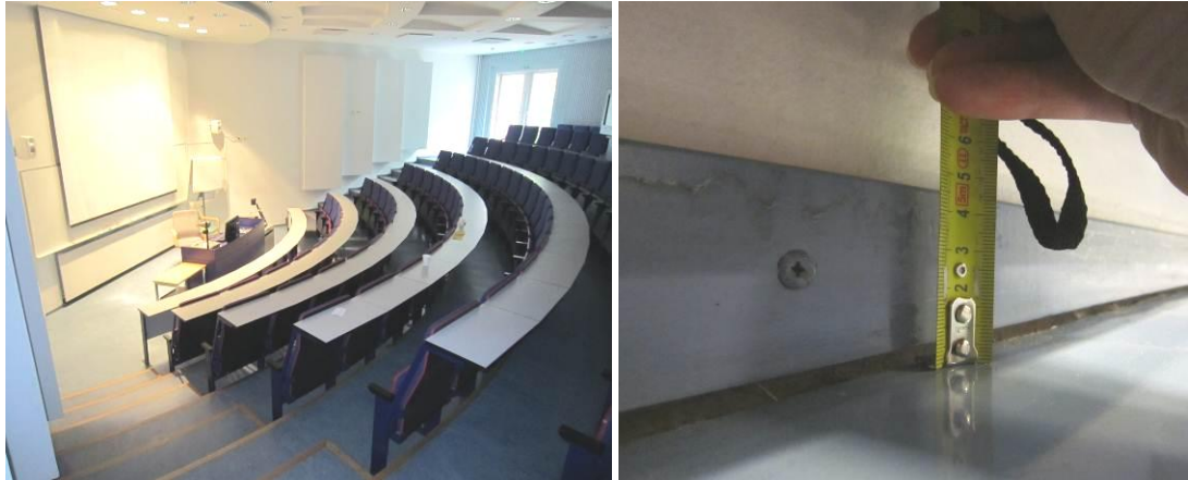
Kuvat 4 a ja b. Castren- salissa on voimakas linoleumimaton haju. Oikealla on lähikuva lattianrajassa havaituista raoista.
