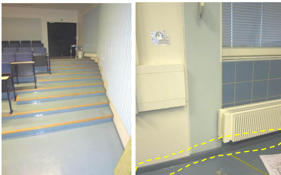
Kuvat 5 a ja b. Auditoriossa LS11 on salin yläosassa kosteaa lattianpäällysteen alla. Salin alaosassa on 5...15 mm rako lattian ja ulkoseinän liitoskohdassa, jossa ilmavirran suunta on maaperästä huonetilaan päin.
