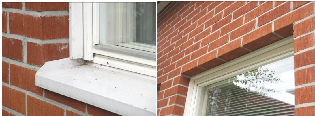
Kuvat 17 a ja b. Ikkunan vesipellit ovat paikoitellen melko vaakasuorat ja niiden päälle lammikoituu vettä. Vesipellin liitoskohdat ikkuna- ja ulkoseinärakenteeseen eivät ole vesitiiviit. Oikealla lähikuvassa on ikkunan ja ulkoseinärakenteen liitospaikka.
