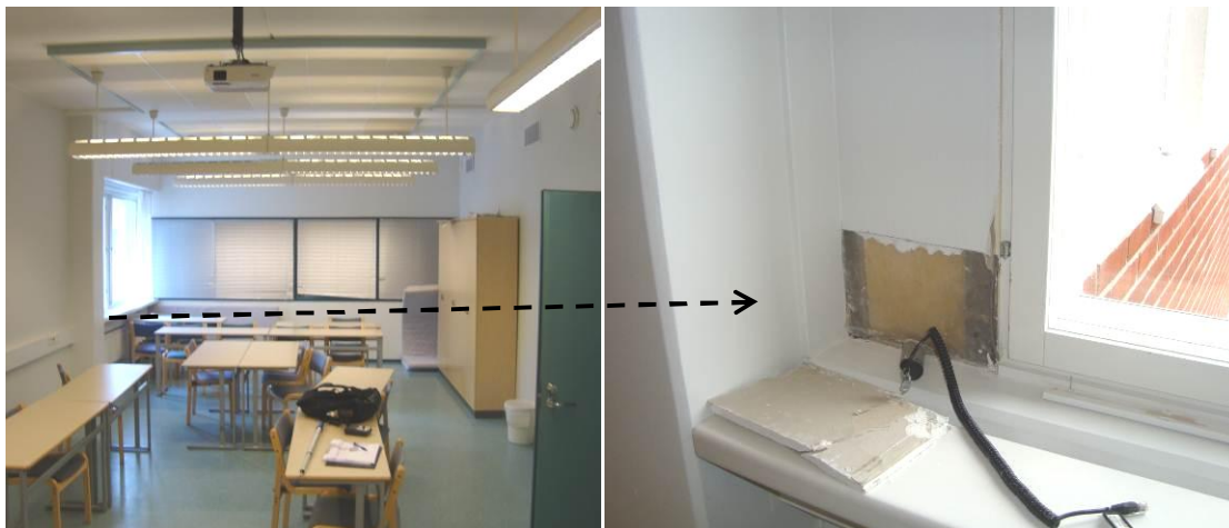
Kuvat 11 a ja b. Ikkunakarmin rakenneavauksessa tilassa 237/238 havaittiin lämmöneristeessä ilmavirtausten mukanaan tuomien epäpuhtauksien tummentaneen mineraalivillaa. Höyrynsulku ei liity tiiviisti rakenteisiin. Lämmöneristekerroksesta mitattiin 50,0 % RH. Mineraalivillasta otetussa materiaalinäytteessä D2.18 analysoitiin selvä mikrobikasvu materiaalissa. Ilmavirtauksen suunta on ulkoa huonetilaan päin.
