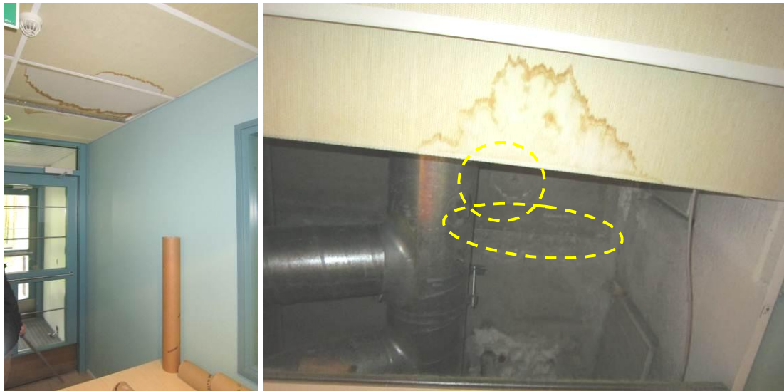
Kuvat 23 a ja b. Ensimmäisen kerroksen käytävän alakattolevyjen vuotojälkiä. Keltaisella katkoviivalla on ympyröity vuodon aiheuttanut ontelotilaan ulottunut porareikä sekä ontelolaattojen sauma.
