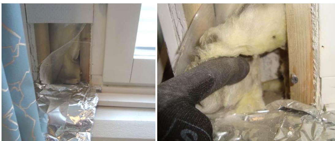
Kuvat 12 a ja b. Toisen kerroksen tilassa S14 tehdyssä rakenneavauksessa D2.22 höyrynsulku ei liity tiiviisti ikkunarakenteisiin. Merkkisavulla havaittiin heikko ilmavirtaus huonetilaan päin. Mineraalivillasta otetussa materiaalinäytteestä D2.22 analysoitiin selvää mikrobikasvua. Mineraalivilla on tummunut ilmavirtausten kuljettamista epäpuhtauksista. Läheltä rakenneavauskohtaa mitattiin ulkoseinän eristekerroksesta 47,0 % RH.
