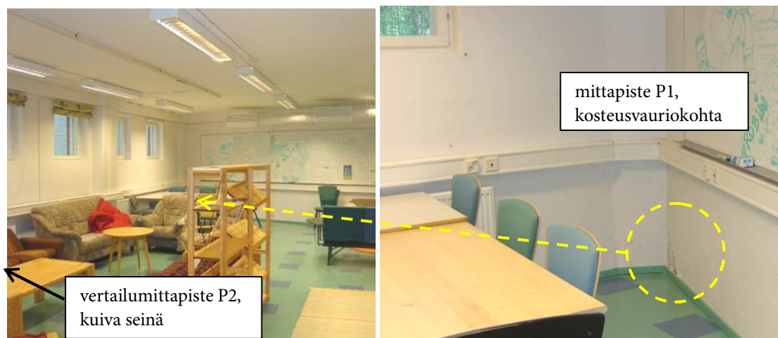
Kuvat 14 a ja b. Kellarikerroksen laajennusosassa tilassa KD028A Ainejärjestöt maali kupruilee maanvastaisessa seinässä. Kosteusmittauksissa seinän alaosan havaittiin olevan märkä. Vertailumittapisteessä seinärakenne oli kuiva.
