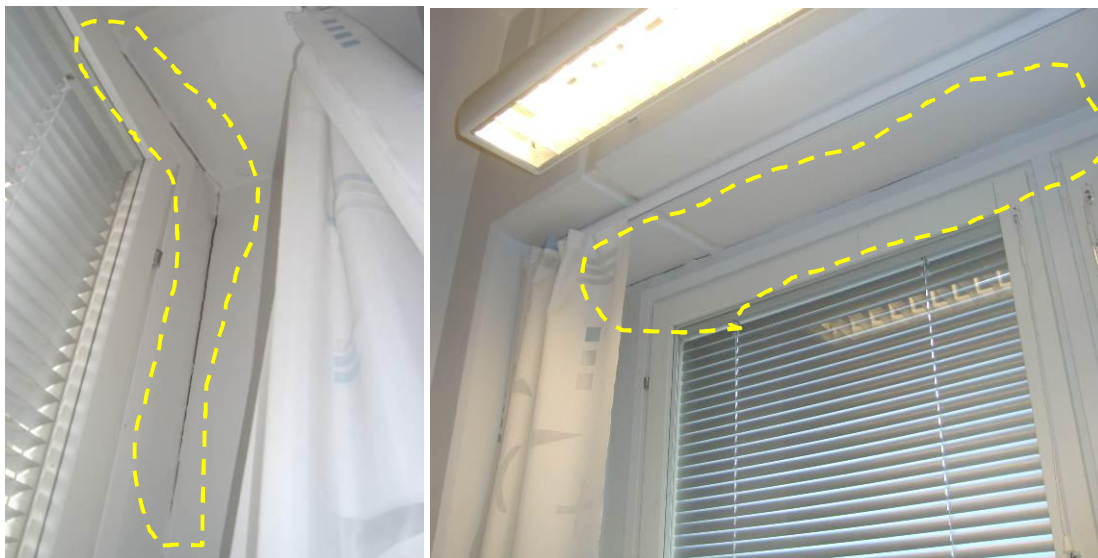
Kuvat 9 a ja b. Tiloissa D 225 ja D231 havaittiin ikkunan ja ulkoseinärakenteen liitoskohdassa rakoja. Vastaavia rakoja havaittiin lähes kaikissa toisen kerroksen huonetiloissa.
