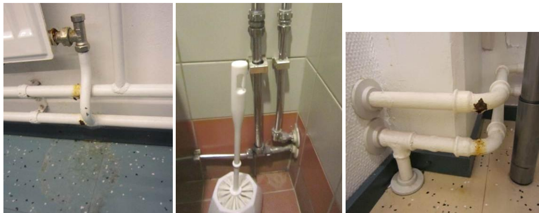
Kuvat 24 a ja b. Vasemmalta oikealle: lämmityspatterien venttiilien kohdalla havaittiin pieniä vuotojälkiä tiloissa D242, D115 ja D202.
