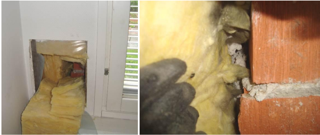
Kuvat 13 a ja b. Ulkoseinän rakenneavauksessa D2.1 käytävällä huoneen 209 edessä havaittiin, että tiilipintaa vasten oleva mineraalivilla on tummunut ilmavirtojen mukanaan tuomista epäpuhtauksista. Mineraalivillasta otetussa materiaalinäytteessä D2.1 ja kipsilevystä otetussa näytteessä D2.2 ei ollut mikrobikasvua.
