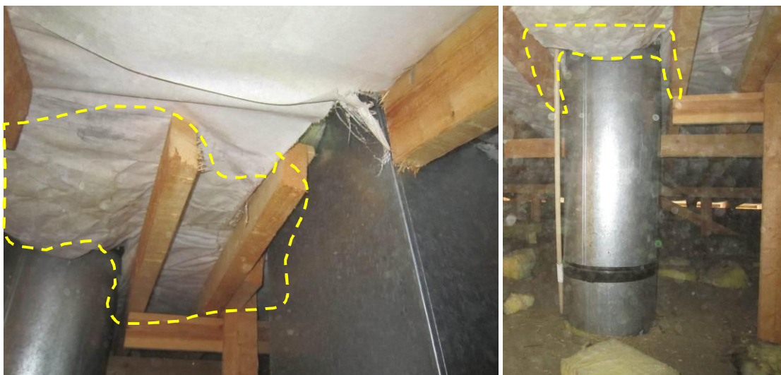
Kuvat 28 a ja b. Aluskatetta ei ole liitetty tiiviisti läpivienteihin. Läpivientien kohdalla havaittiin paikallisia vuotojälkiä. Oikealla näkyvät myös räystään tuuletusaukot.
