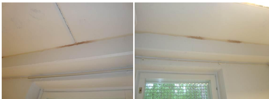
Kuva 20. Työmaa-aikana asennuksen yhteydessä käytetyt kumiset erotuskaistat värjäävät kittisaumoja. Tummentuneita saumoja havaittiin kaikissa kerroksissa.
