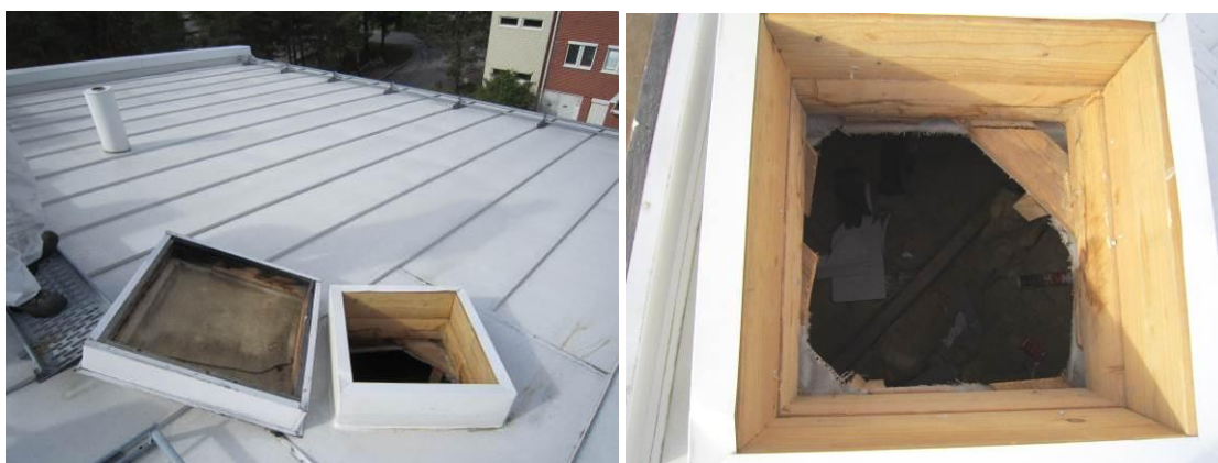
Kuvat 29 a ja b. Kolmikerroksisen osan eteläpäädyssä havaittiin kattoluukun kohdalla kosteusjälkiä. Yläpohjan ilmatila kattoluukun alapuolella oli kuiva. Oikealla lähikuva kattoluukusta, jossa aluskatetta ei ole nostettu kattoluukun reunoille.
