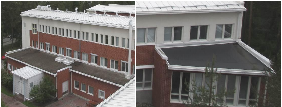
Kuvat 31 a ja b. D-osan bitumikermikattoja. Oikealla: pohjoispäädyssä peltikaton vedet ohjataan tilan D111 bitumikermikaton päälle. Syöksytorven kohdalla sadevesi roiskuu ulkoseinälle ja ikkunoihin. Loivalle bitumikermikatolle lammikoituu vettä.
