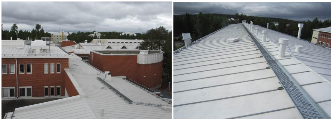
Kuvat 26 a ja b. Vasemmalla D-siiven länsipäädyn vesikattoja, joita ei päästy tarkastamaan. Oikealla kuvassa on eteläpäädyn peltikatto.
