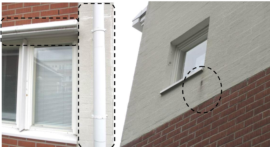
Kuvat 16 a ja b. Ikkunan yläpuolella olevissa lipassa on veden valumajälkiä. Syöksytornin kohdalla julkisivussa on valumajälkiä. Ohutrapatussa julkisivussa on paikoitellen oikeanpuolimmaisien kuvan kaltaisia valumajälkiä.
