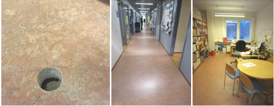
Kuvat 15a, b ja c. Vasemmalla kuva väestönsuojan täyttökerrokseen poratusta reiästä huoneessa A187. Välipohjien linoleumilattianpäällysteet olivat kaikissa uuden osan tiloissa hyväkuntoisia.
