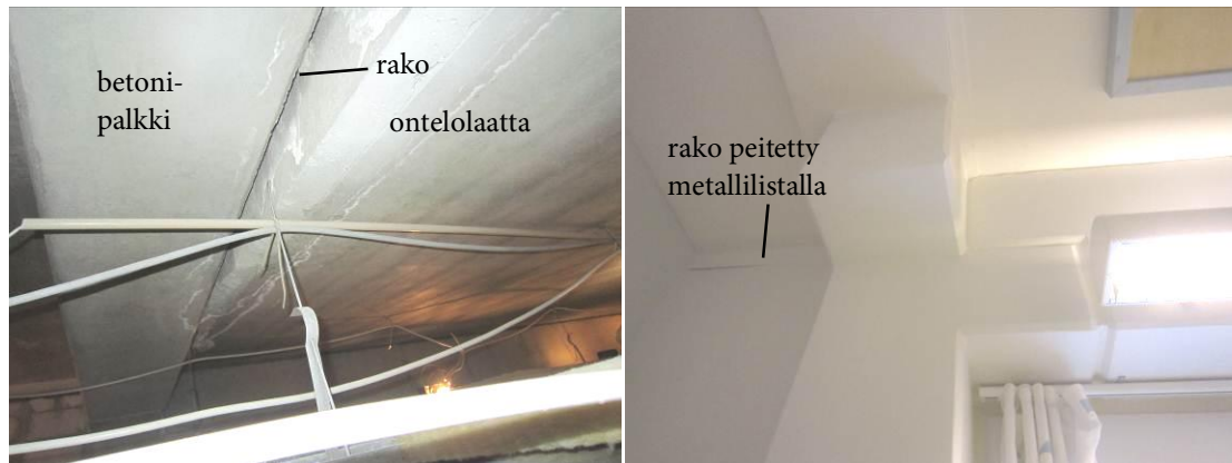
Kuvat 22a ja b. Vasemmalla: A-siiven vanhan osan aulassa yläpohjan betonipalkin ja ontelolaatan liitoskohdassa on rako. Raon kautta on joskus valunut vettä, tarkasteluhetkellä rakenteet olivat kuivat. Oikealla tila A242, jossa metallilistalla on peitetty rakenteiden välissä olevia rakoja.
