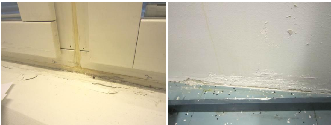
Kuvat 8 a ja b. Tilassa A201 ikkunan ja betonisisäkuoren maalipinnat kupruilevat. Jalkalistan takana kupruilee myös maali. Ikkunoiden liitoskohta ja ikkuna-betonisisäkuoriliitoskohta on tiivistetty hyvin elastisella saumamassalla.
