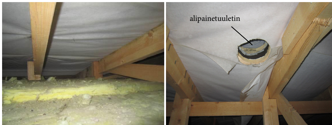
Kuvat 19a ja b. Aluskate ulottuu räystäällä ulkoseinän ulkopuolelle asti. Aluskatetta ei ole liitetty tiiviisti läpivienteihin. Oikealla tiivistämätön alipainetuuletin. Valokuvat ovat vanhan osan vesikatolta.
