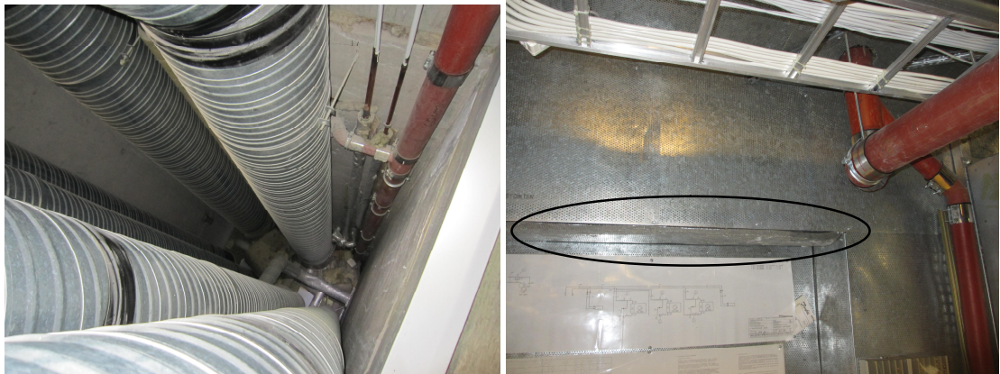
Kuvat 29a ja b. Vasemmalla: Vanhan osan iv-kuilun pohjalla on rakennusjätettä. Oikealla: läpiviennin kohdalla on joskus tapahtunut vuotoja. Merkityllä alueella havaittiin vanhoja vuotojälkiä.
