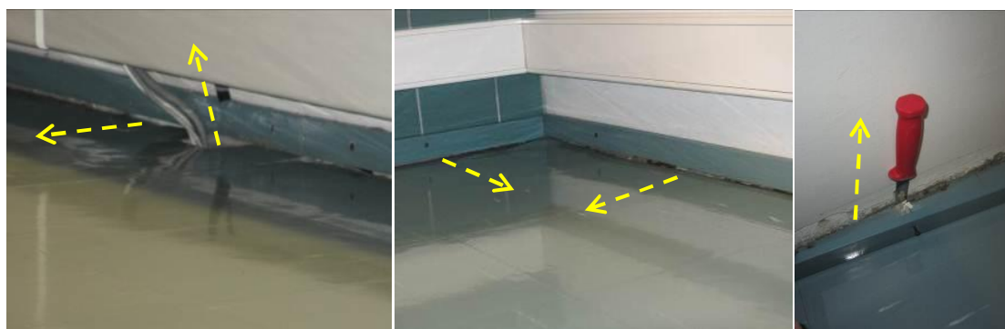
Kuvat 5a, b ja c. Luentosaleissa A140 ja A141 havaittiin alapohjan ja ulkoseinän liitoskohdassa rako lattianrajassa. Alapohjajalassa on tiivistämättömiä läpivientikohtia.
