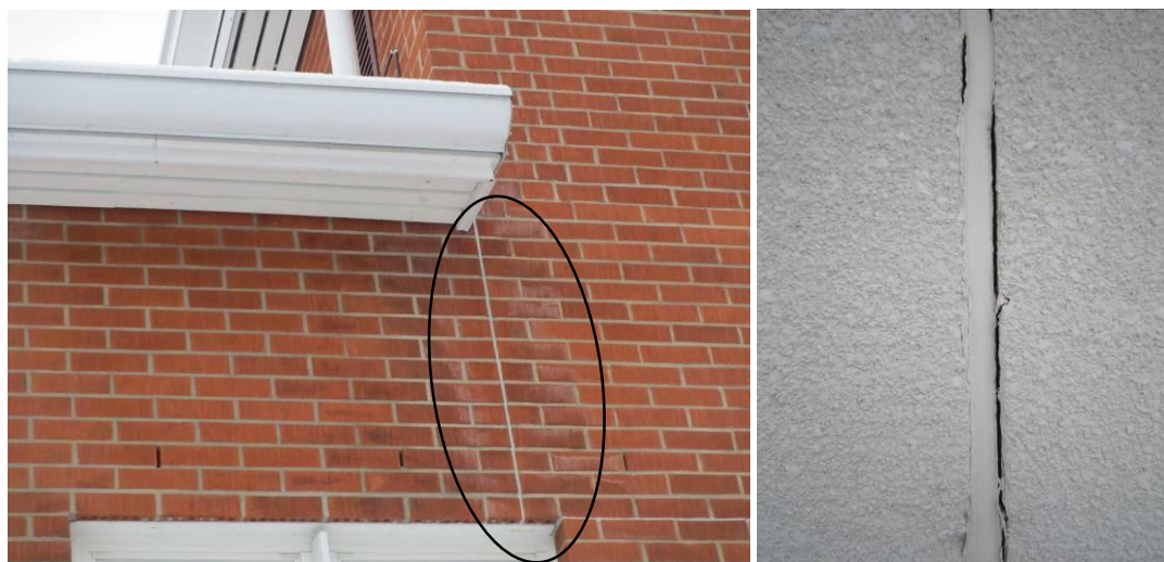
Kuvat 12a ja b. Vasemmalla huoneen A213 kohdalla vesikaton vedet valuvat julkisivulle ja rakenteiden sisälle mm. saumakohdasta. Oikealla lähikuva A-siiven vanhan osan julkisivun saumasta huoneen A244 ja A245 välissä.
