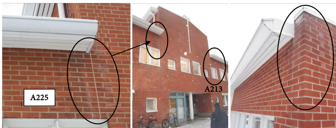
Kuvat 13a, b ja c. A-siiven vanhassa ja uudessa osassa havaittiin lähes kaikkien kattolappeiden nurkkakohdissa veden valumajälkiä. Katoilla oleva vesi ohjautuu osittain vesikourujen ohi.
