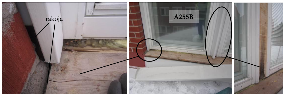
Kuvat 28a, b ja c. A-siiven uuden osan bitumikermikaton liittymä ulkoseinä- ja ikkunarakenteeseen tehtiin rakenneavaus arkistotilan A255B kohdalle. Pellin ylösnoston ja ulkoseinärakenteen välissä on rako. Kosteusrasitusta havaittiin ikkunoiden liitoskohdan vanerilevyssä.
