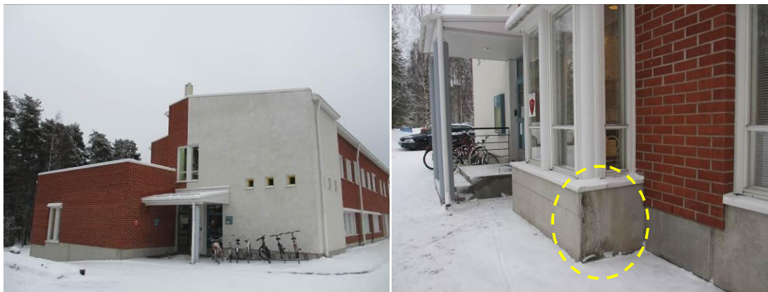
Kuvat 2a ja b. Vasemmalla A-siiven pohjoispääty. Oikealla eteläpäädyn erkkeri, jossa havaittiin paikallinen sadevesien aiheuttama kosteusrasitus.
