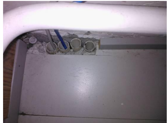
Kuva 8. Kabinetin (C182) lattian läpivienti on tiivistämättä
