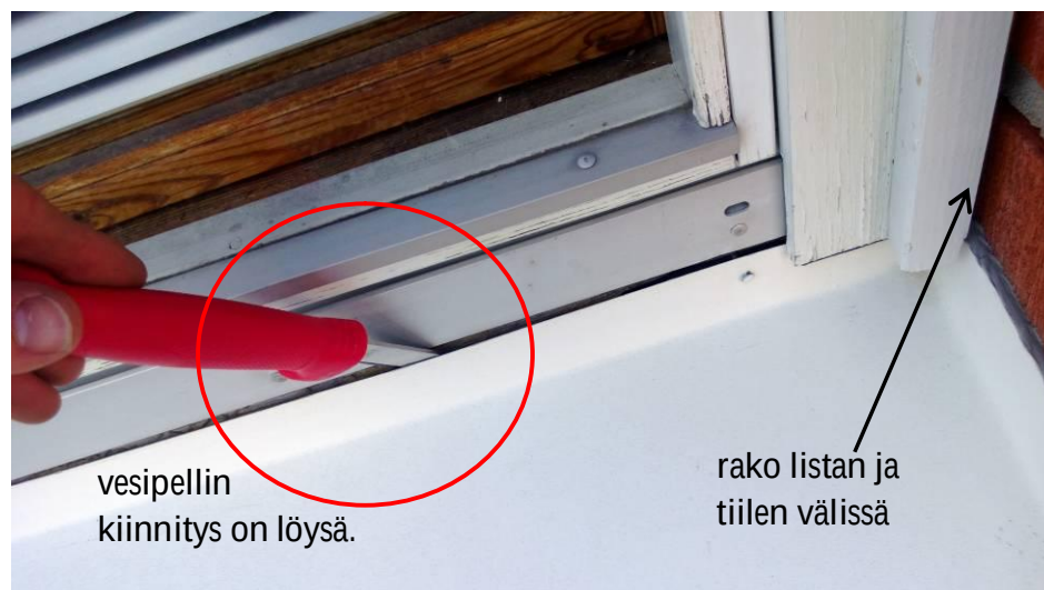
Kuva 20. C-osalla ikkunoiden vesipellit ja listat eivät olleet vesitiiviitä.
