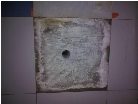
Kuva 7. Ruokalan (C159 ja C182) lattian kvartsivinyylilaatat ovat paikoin irronneet alustastaan. Betonipinnalla on havaittavissa kosteuden aiheuttamia jälkiä.
