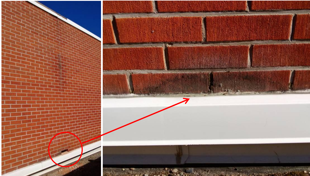
Kuvat 19 a ja b. Rakennusaukoissa 8 auditorion seinässä. Alimmassa näkyvässä tiilivarvissa oli kosteuden viittaava jälki.
