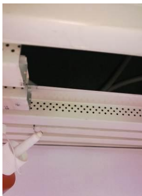
Kuva 25. ATK-luokan katon tarkastusluukusta on ilmayhteys tekniikkakuiluun. Kuilusta on ilmavirtaus luokkatilaan päin
