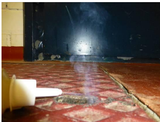
Kuva 1. Kellarin lattiassa (KC008) olevasta öljysäiliötilan luukusta on ilmavirtaus sisään
