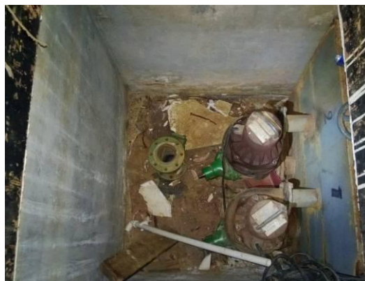
Kuva 2. Öljysäiliötilan lattian on maapohjalla ja siellä on rakennusjätettä.
