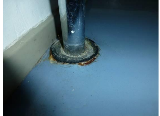
Kuva 22. Käsienpesualtaan (C249) lattialäpivienti on puutteellisesti tiivistetty
