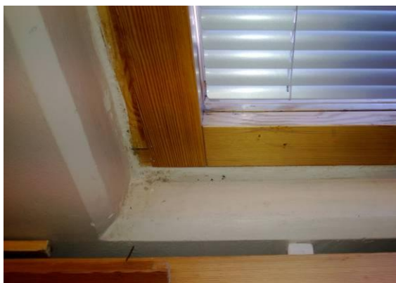
Kuva 11. Huoneen C359 elastisella massalla tiivistetystä karmin ja sisäkuoren liittymästä ei havaittu merkkiainevuotoa
