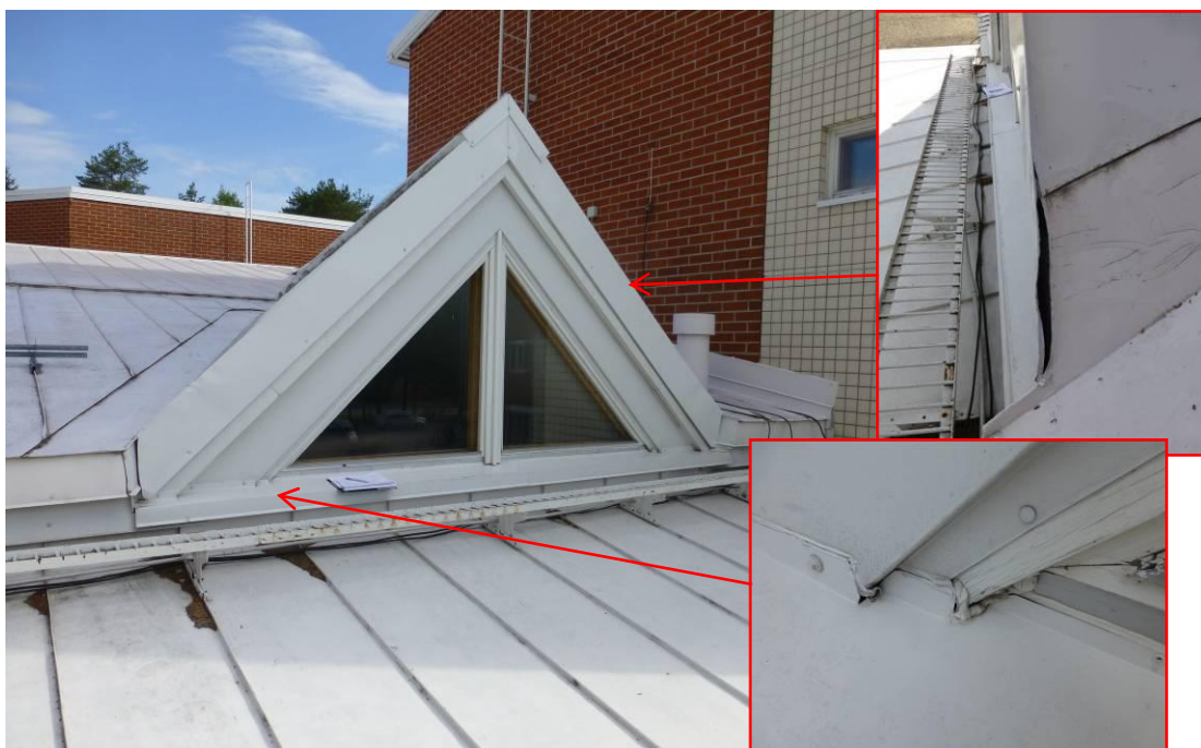
Kuva 29. Ikkunoiden saumaukset ovat ikääntyneet ja kovettuneet.
