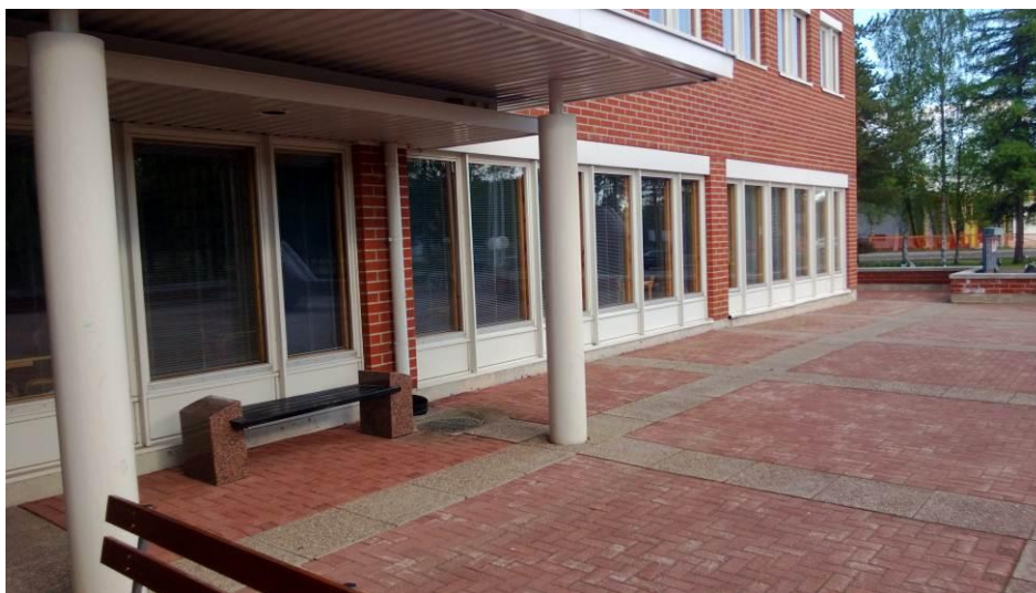
Kuva B. Ruokalan vierustan kiveyksen kallistus on vähäinen. Vastaava puute havaittiin monin paikoin erityisesti C-siiven eteläpuolella.
