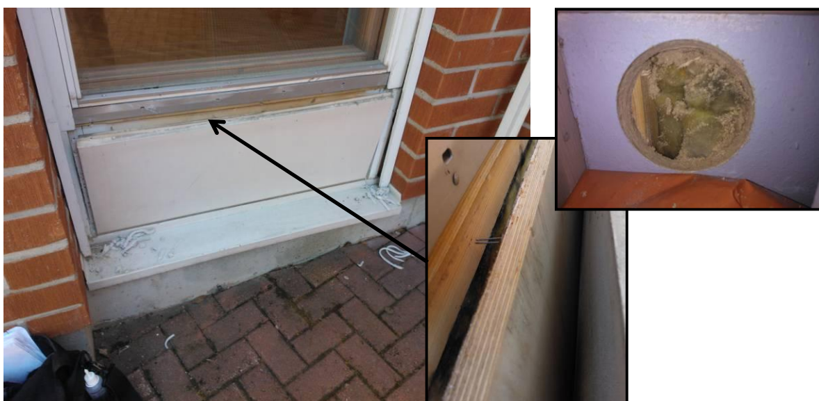
Kuva 16 a ja b. Auditorion (C147) levyrakenteisen ulkoseinän sisä- ja ulkopuolisessa rakenneavauksesta (RA2) havaittiin tummentumia lämmöneristeissä. Rakenteessa ei ole höyrynsulkumuovia.
