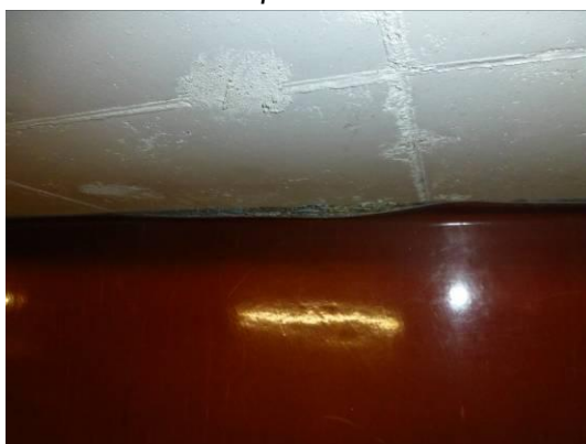
Kuva 3. Muovimatto on irronnut alustastaan kellarin ulkoseinälinjalta (KC008)
