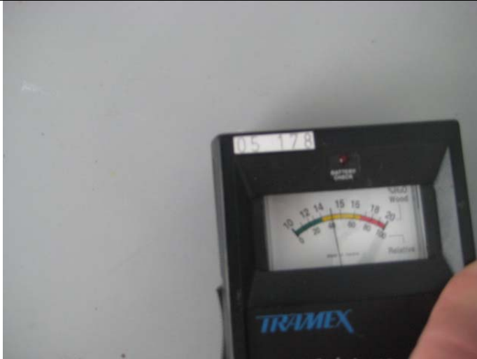
Kuva 2. Välipohjassa esiintyi kosteuspoikkeamaa.
