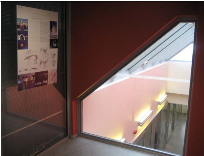
Kuva 9. 4. kerroksen terassi on vuotanut kolmannen kerroksen valoaulaan. Terassi on korjattu, mutta vuodosta on vielä merkkejä.
