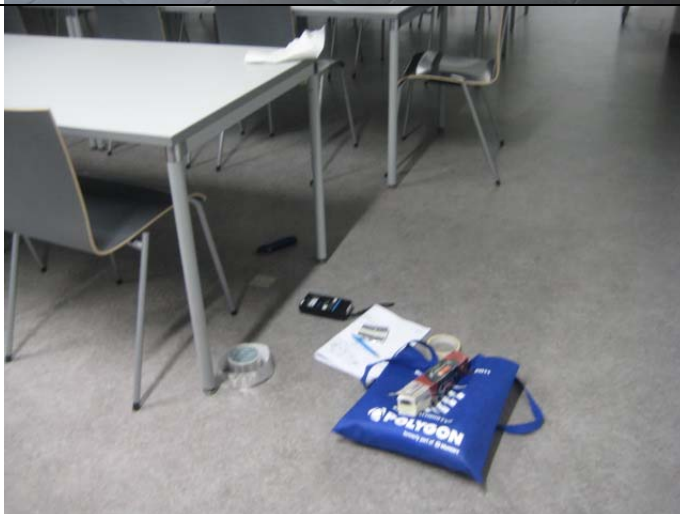
Kuva 6. Yleisin ja eniten käytetty lattiapinnoite oli liimattava kerroksellinen muovimatto. Poikkeuksetta tiloissa esiintyi kosteuspoikkeamaa.
