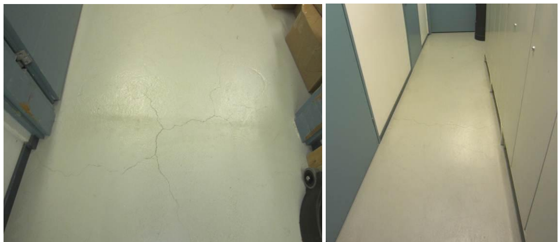
Kuvat 3 a ja b. Halkeamia kellarikerroksen lattioiden maalatussa betonipinnassa varastotilassa KE019 sekä käytävällä KE023.
