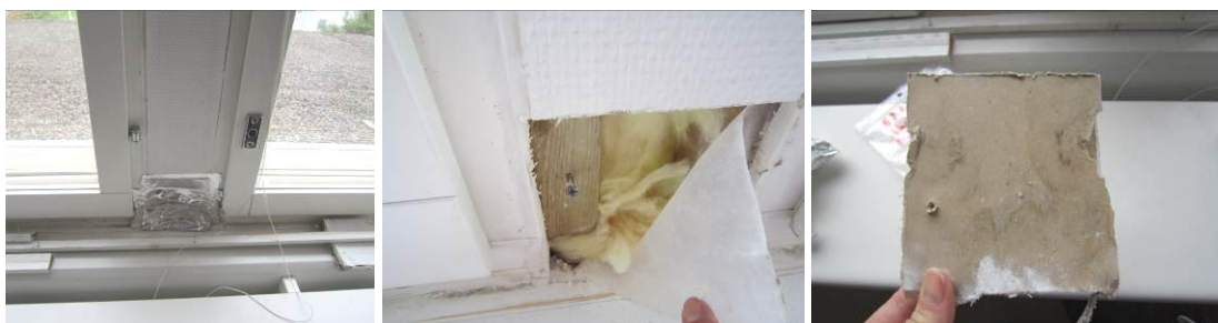
Kuvat 11 a, b ja c. Toisen kerroksen toimistohuoneen E253 ikkunan kohdalle tehdystä rakenneavauksessa E2.2 havaittiin jälkiä kosteusrasituksesta. Tarkasteluhetkellä rakenteet olivat kuivat eikä poikkeavia hajuja havaittu. Rakenneavauksesta havaittiin voimakas ilmavirtaus huonetilaan päin. Lämmöneristeestä (E2.21) ja kipsilevyn kartongista (E2.22) otetuista materiaalinäytteistä analysoitiin selvä mikrobikasvu materiaalissa.
