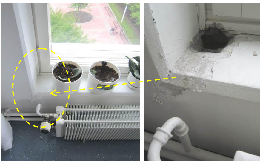
Kuvat 13 a ja b. Toimistohuoneen E328 ikkunan alanurkassa betoniseinän maalipinta kupruilee ja ikkunan puuosissa maali hilseilee ja puuosissa on kosteusrasituksen jälkiä. Rakenneavauksessa E3.2 ei havaittu poikkeavia hajuja.
