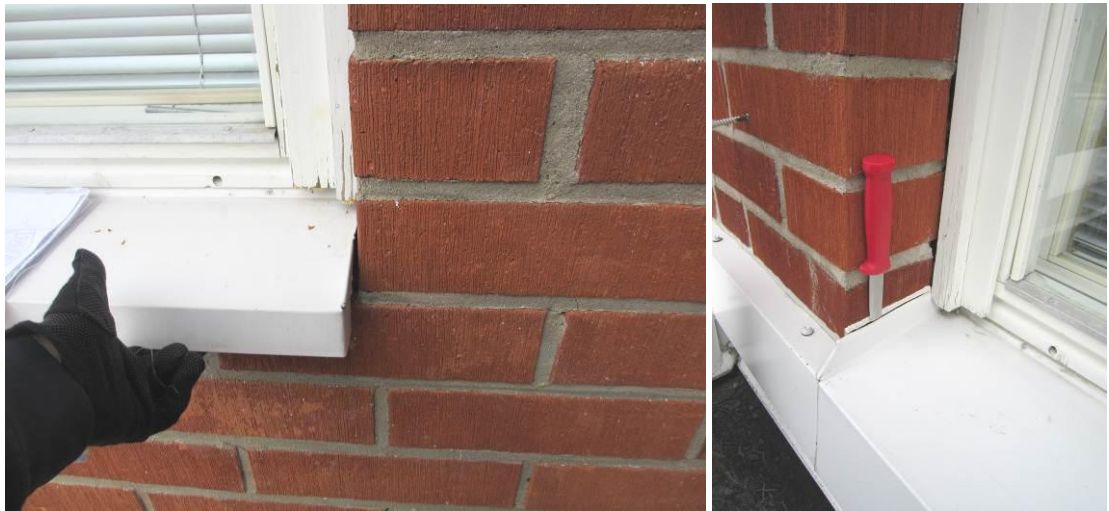
Kuvat 18 a ja b. Ikkunapellitykset on kiinnitetty nauloilla ikkunan karmiin eikä pellin ja tiiliseinän liitoskohtia ole tiivistetty. Peltejä on helppo liikutella ja pellin alla on suoraan yhteys ulkoseinän eristetilaan.
