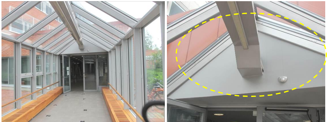
Kuva 31. Lasikäytävällä on vanhoja valumajälkiä F-siiven päässä. Vesisateella lasikatto ei vuotanut.
