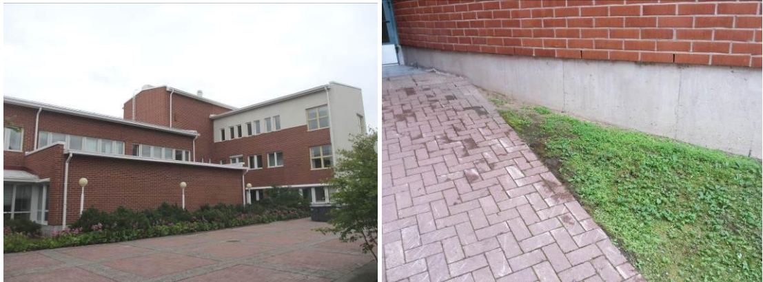
Kuva 33. Runsas kasvillisuus julkisivun vieressä pitää maaperän kosteana. E-siiven sokkelit ovat kuitenkin hyväkuntoiset.
