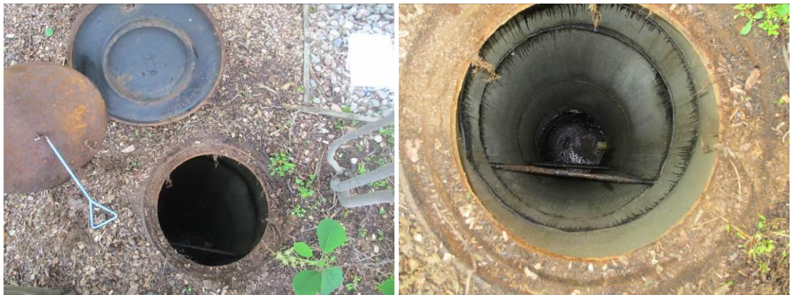
Kuva 34. Salaojaverkoston tarkastuskaivon pohjalla havaittiin hiukan vettä. Tarkastuskaivon kannesta vesipintaan on noin 3500 mm.
