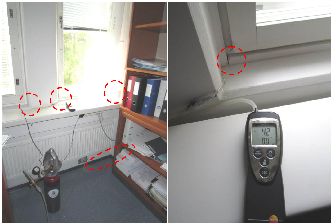
Kuvat 21 a ja b. Tilassa E340-E341 havaittiin ilmavuotoa lattianrajassa pilarin ja lattian liitoskohdassa sekä vähäistä ilmavuotoa ikkunan karmiliitoksissa, kohdat on merkitty kuvaan punaisella katkoviivalla. Tilassa mitattiin ulkoseinän yli 4...6 Pa alipaine. Merkkikaasua syötetään ulkoseinärakenteeseen rakenneavauskohdasta E3.5.
