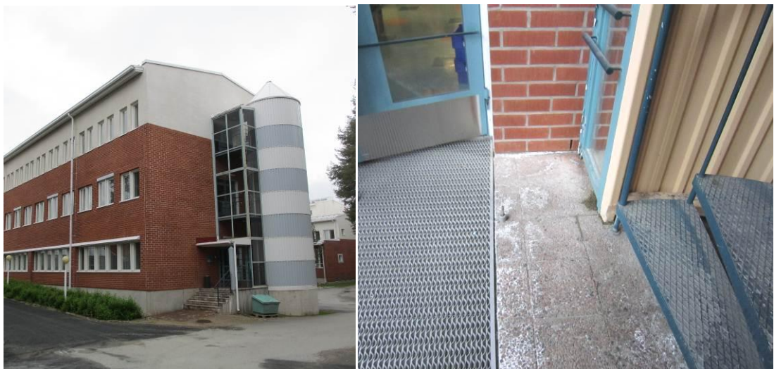
Kuvat 20 a ja b. E-siiven päädyssä oleva porrashuone päästää sadevedet sisään ja vedet kastelevat porrashuoneen rakenteita sekä julkisivua.
