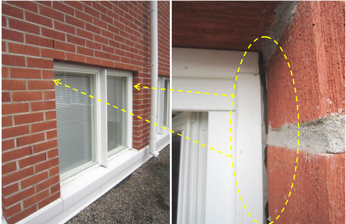
Kuvat 19 a ja b. Ikkunan ja tiilimuurauksen liitoskohdissa on rakoja. Epätiivit pystysaumot päästävät sadeveden ulkoseinärakenteen sisälle.
