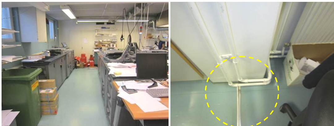
Kuvat 5 a ja b. Laajennusosan Lapin yliopistopainon tiloissa lattianpäällysteet ovat hyväkuntoiset. Ilmavuotoa huonetilaan päin havaittiin tilassa KE031 pilarin ja alapohjan liitoskohdassa, jossa lattiassa on liikuntasärmä (kuva oikealla).
