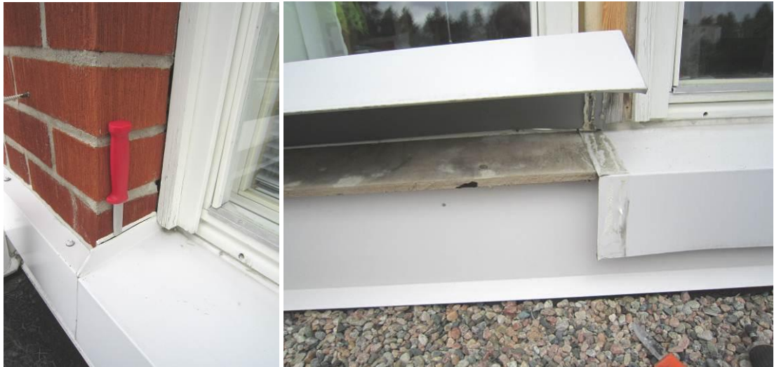
Kuvat 30 a ja b. Rakenneavauksessa E2.6 havaittiin, että bitumikerman ylösnoston korkeus on noin 300 mm. Bitumikerman ylösnosto sijaitsee oikeanpuolimmaisessa kuvassa näkyvän alemman suojapellin takana.
