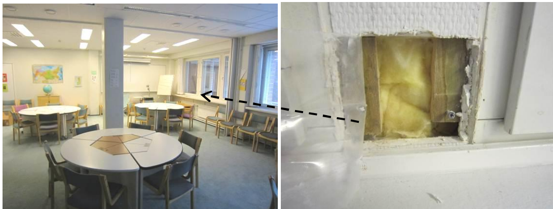
Kuvat 10 a ja b. Kielistudion E123-E124 ikkunan rakenneavauksessa E1.2, karmin kohdalta otetussa mineraalivillaeristeessä ei analysoitu mikrobikasvua (näyte E1.2). Höyrynsulku ei liity tiiviisti ikkunan karmirakenteisiin. Rakenteista havaittiin voimakas ilmavirtaus huonetilaan päin.
