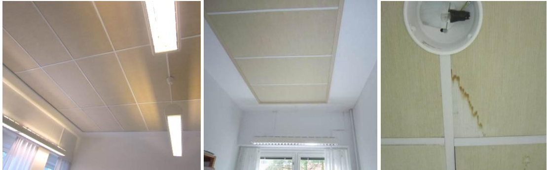
Kuvat 25 a, b ja c. Kattopintoihin kiinnitetyt akustointilevyt olivat hyväkuntoisia. Ensimmäisen kerroksen käytävällä E134A havaittiin pieni vanha vuotojälki alakattolevyssä.
