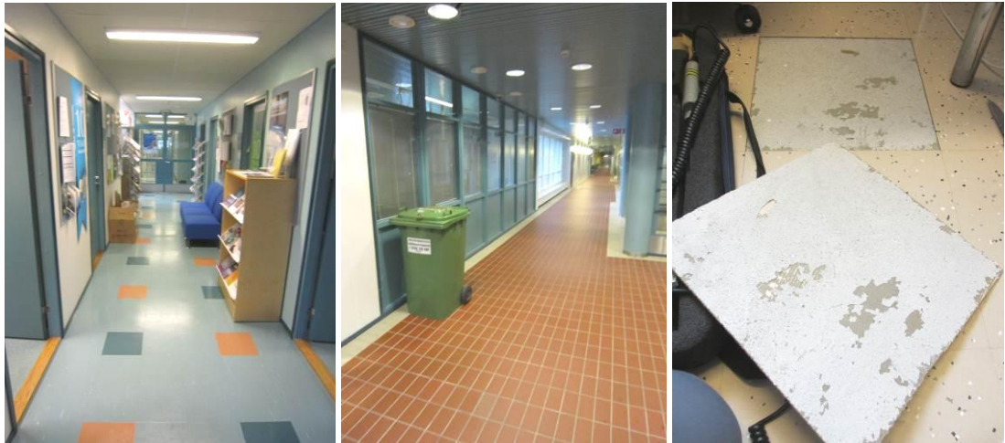
Kuvat 22 a, b ja c. Hyväkuntoisia lattianpäällysteitä toimistotiloissa sekä aulassa käytävällä. Oikealla toimistohuoneessa viiltokosteusmittauksen V3.4, (57,5 % RH) jälkeen irrotettu kvartsivinyylilaatta, joka irtosi helposti alustastaan. Tasoitekerroksesta aistittiin hieman pistävä haju.
