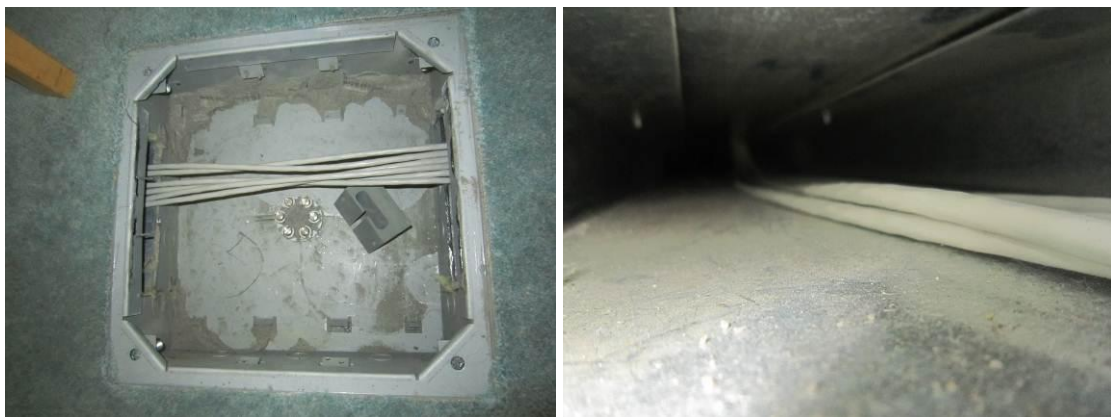
Kuvat 24 a ja b. Sähköasennuskouruissa ja niiden asennusluukuissa havaittiin pölyä, roskaa ja mineraalivillaa. Kuva on tilasta E123-E124, Kielistudio.
