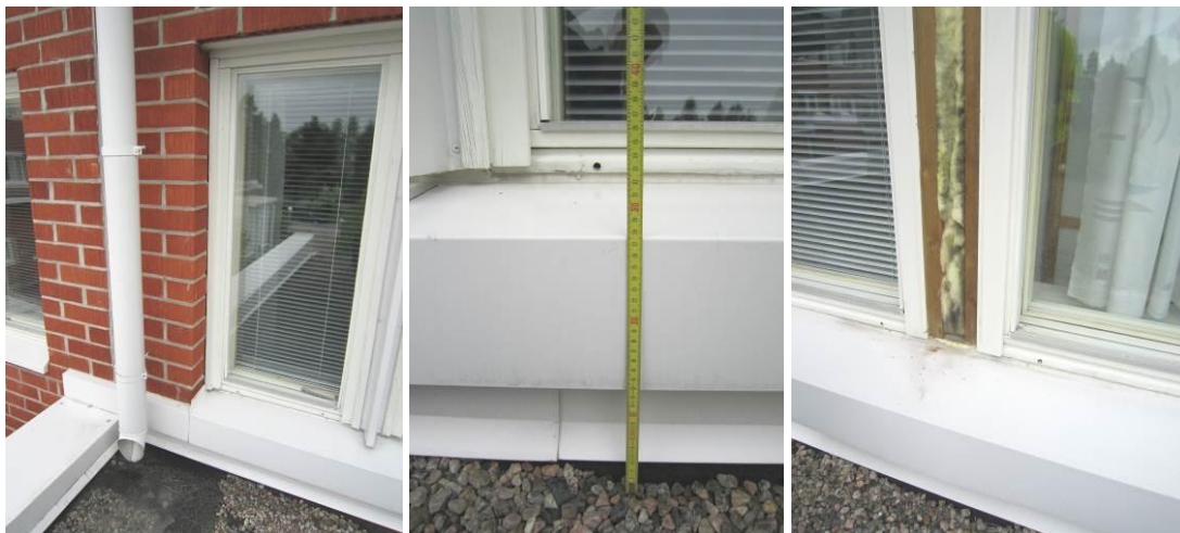
Kuvat 12 a, b ja c. Toimistohuoneen E253 ulkopuolelle tehdyssä ikkunan rakenneavauksessa E2.6 havaittiin tummunutta mineraalivillaa ja kosteusjälkiä ikkunarakenteissa myös ikkunan pellitysten alla.
