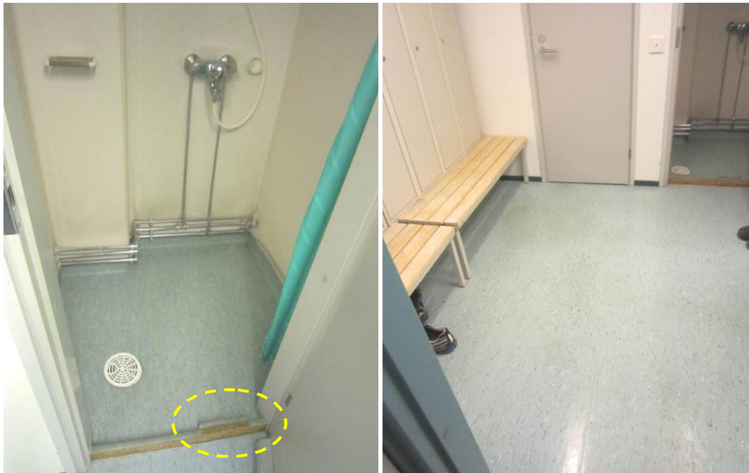
Kuvat 4 a ja b. Pukuhuoneissa KE018A ja KE018B muovimatto on irti alustastaan ja matto sekä mattoliima ovat alkaneet vaurioitua kosteusrasituksessa. Vasemmalla on suihkunurkkaus, jonka kynnyksellä muovimatto on repeytynyt.
