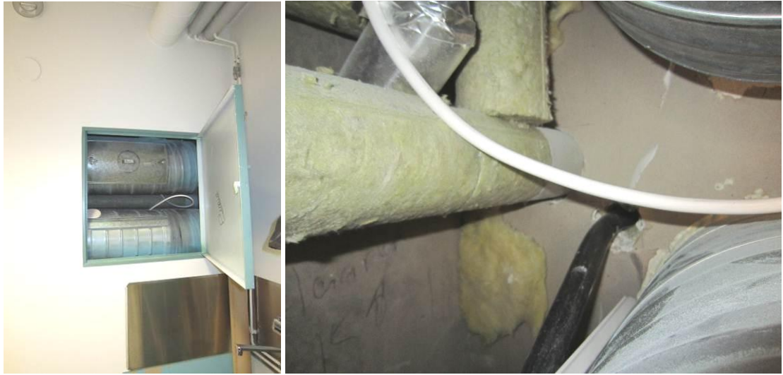
Kuvat 16 a ja b. Laajennusosan kellarikerroksen putkikanaalista virtaa ilmaa tarkastusluukun kautta huonetilaan päin. Oikealla lähikuva putkikanaalin sisältä.
