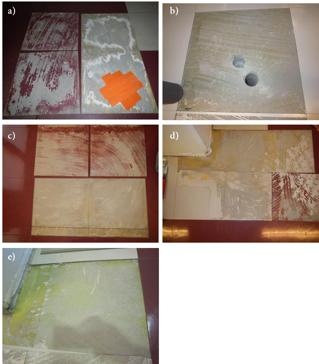
Kuva 3. Lattiapäällysteenä olevan kvartsivinyytilaatan liimakerroksen vaurioita laattojen reuna-alueilla a) kirjaston ATK-työpisteellä (Ra 1.7), b) huoneessa B108, c) lukusalissa (Ra 1.8b), d) kirjastosalissa (Ra 1.8a) ja e) työhuoneiden edustalla (Ra 1.8c). Päällystelaatat on käännetty ”auki” irrotuskohdan viereen.
