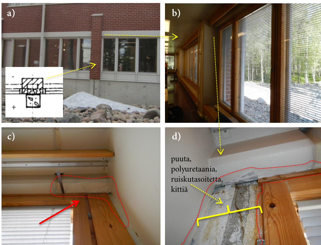
Kuva 30. Kirjastosalin ikkunan ja pilarin liitoksessa (a, b) todettiin kosteusvaurioon viittaavaa tasoitteen kupruilua ja kellastumaa vaakapalkin ja puuosien pinnoilla pilarin molemmiin puolin (c ja d). Liitos tutkittiin rakenneavauksella (Ra 1.10) puisen peitelistan takaa (d). Listan takana oli tiivistämätön höyrynsulkumuovi. Ikkunan ja palkin välinen rakenne on toteutettu usealla kerroksella puurunkoa, polyuretaanivaahtoa ja kittiä. Materiaalien pinnassa oli runsaasti ruiskutasoitetta, jossa oli havaittavissa kosteusvauriojälkiä. Pilarin takana on rakennekuvan (a) mukaan mineraalivillaeriste. Rakenne oli epätiivis.
