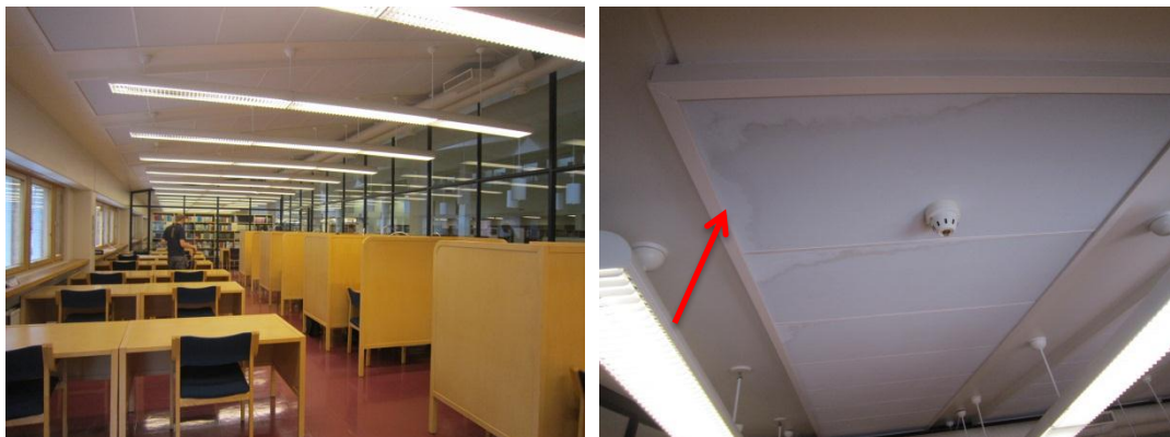
Kuva 59. Kosteusvauriojälkeä lukusalin katon akustolevyissä.
