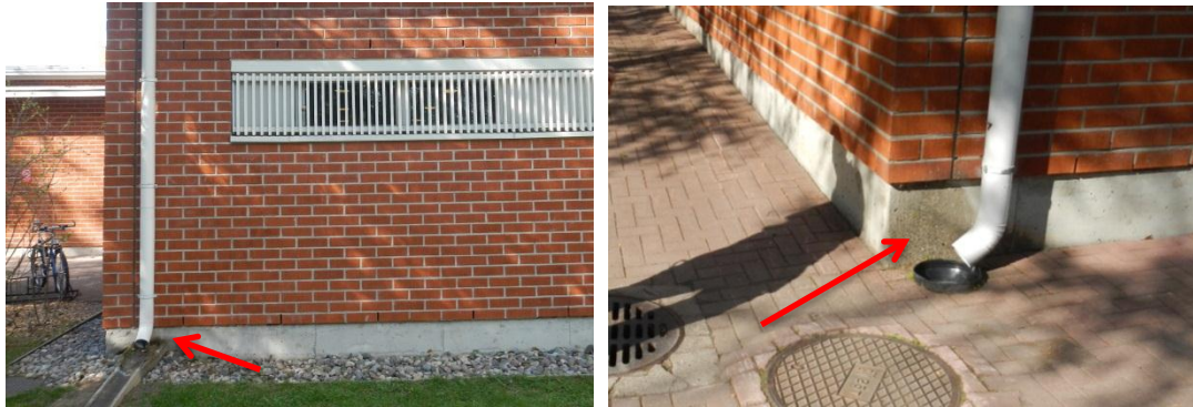
Kuva 15. Sadevedet kastelevat paikoin sokkeleita. Kastuneet alueet ovat pienialaisia, eikä niistä nykyisellään aiheudu merkittävää kosteusrasitusta rakenteen sisemmille osille.
