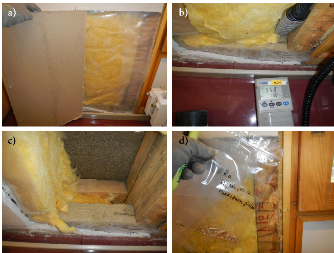
Kuva 33. Rakenneavaus Ra 1.6a. Rakenteessa on höyrynsulkumuovi, joka on asennettu epätiivisti puurungon sisäverhouskipsilevyn taakse (a). Muovia ei ole tiivistetty lainkaan ikkunan runkopuun liitoksesta. Lämmöneristekerroksessa todettiin vähäistä ilmavuotoja lähinnä alapuiden välisessä tilassa. Rungon sisäpinnalla ja alaosassa oli havaittavissa pinnallista kosteusrasituksen aiheuttamaa jälkeä (c, d). Rakenteessa ei todettu normaalista poikkeavaa hajua. Runkopuun sisäpinnasta kerättiin materiaalinäyte (M5). Näytteessä ei todettu mikrobikasvua. Rakenteet todettiin piikkimittarilla tutkittuna ja eristetilan olosuhdemittauksella tarkasteltuna kuiviksi. (b).
