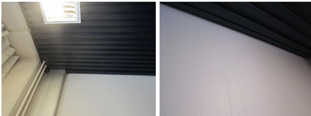
Kuva 45. Taukotilan B206 ulkoseinänurkassa havaittiin kosteusjälkeä alakatossa ja valumajälkiä tilan B204 vastaisella seinällä. Alakattotilassa ei havaittu vauriojälkiä tai vuodon lähdettä.
