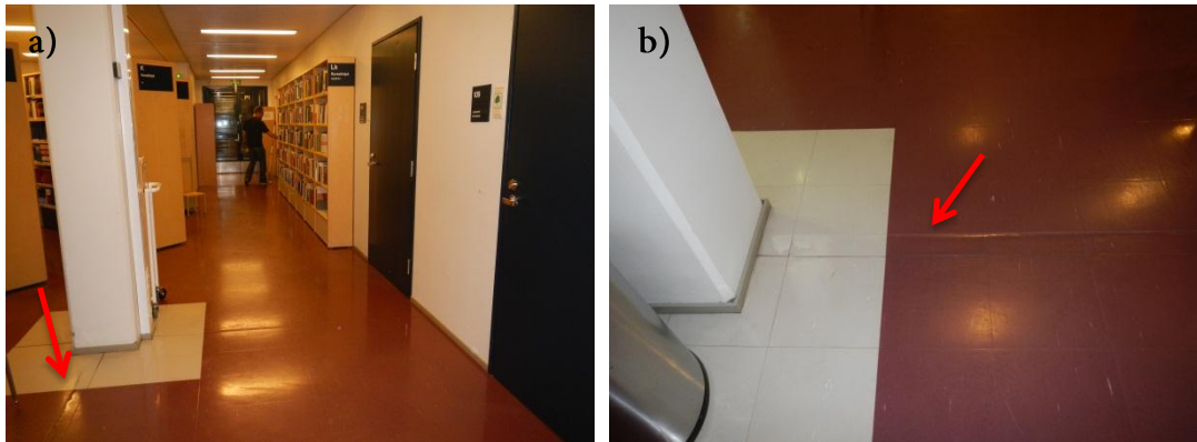
Kuva 5. Halkeamia kirjastosalin lattiassa alapohjarakenteen liitoskohdissa työhuoneiden viereisellä käytävällä (a) ja ATK-pisteen lähellä (b).
