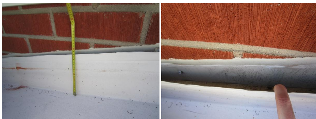
Kuva 49. Uuden peltikatteen ylösnosto ei liity tiiviisti tiiliverhoukseen. Vanhan vesikatteen ylösnosto kuitenkin suojaa tiiliseinää. Kohdassa ei havaittu viitteitä julkisivuun kohdistuvasta korkeammasta kosteusrasituksesta.
