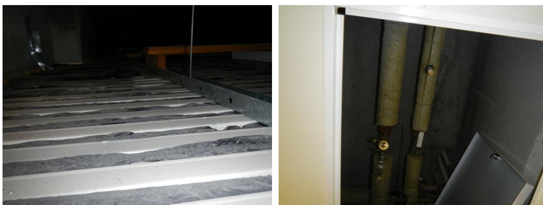
Kuva 46. 1. krs ritiläalakattojen päällä on muovipussitettua mineraalivillaa. Alakattotiloissa oli monin paikoin suojaamattomia villaeristettyjä putkia ja runsaasti pölyä.
