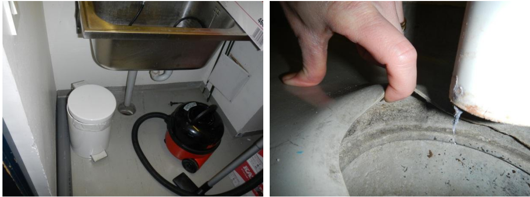
Kuva 4. Siivousskomerossa B106 on puutteellisesti asennettu lattiakaivo ja pesualtaan viemärointi.
