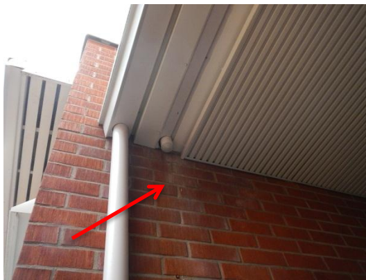
Kuva 16. Kattolipan puutteellinen sadevedenpoisto kastelee tiilijulisivua rakennusosan eteläpään sisäänkäynnin vieressä. Sisäpuolella on tila A142. Tilan sisäpinnoilla ei todettu poikkeamia aistinvaraisella arvioinnilla ja pintakosteuskartoituksessa.
