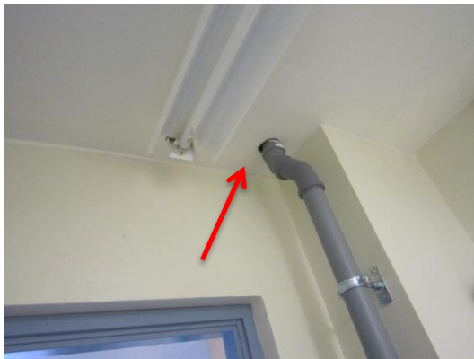
Kuva 66. tiivistämätön putkiläpivienti yläpohjaan huoneessa B305.
