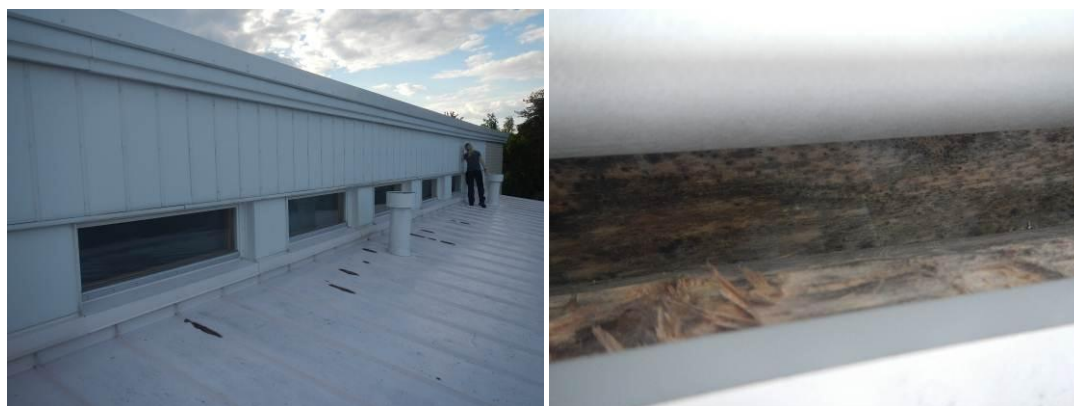
Kuvat 50 a ja b. Kuvissa länsi- ja itälape. Länsilapteen räystäällä havaittiin sinistyneitä puuosia. Puuosat havaittiin lujiksi.
