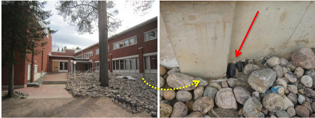
Kuva 18. Kirjastosalin julkisivulla oli näkyvillä tiivistämättömiä sähköläpivientejä kellarikerroksesta ulos.
