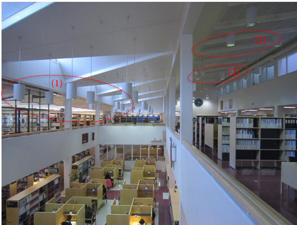
Kuva 57. Kirjastosalin katossa todettiin kosteusvauriojälkiä kattolyhtyjen alapuolella (1) ja ilmavuotojälkiä akustolevyissä ontelolaattasaumojen ja läpivientien/kiinnitysten kohdilla (2). Yläpohja on rakennuosan sivuilla ontelolaattaa, ikkunalyhtyjen välissä on suuret laattaelementit. Ikkunalyhtydyt ovat teräsrunkoiset, sisäpuolelta kipsilevyverhoillut ja päältä vaneroidut/laudoitetut ja pellitetyt. Vesivuotojälkiä oli ikkunalyhtyjen alaosassa ja niiden alapuolella kuvassa vasemmalla näkyvissä 2. krs tiloissa.
