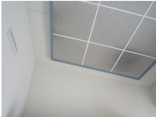
Kuva 69. Tummentumaa akustolevyissä tilan B330 katossa. Jälki ei ole ilmavuodon aiheuttama, vaan on syntynyt tuloilmasuihkun osumisesta kattolevyyn. Tuloilman pääte-elin näkyy kuvassa vasemmalla seinällä. Ilmasuihku aiheuttaa nokihiukkasten kiinnittymisen huokoiseen pintaan. Vastaavia jälkiä oli useimmissa työhuoneissa. Jäljet eivät edellytä toimenpiteitä.
