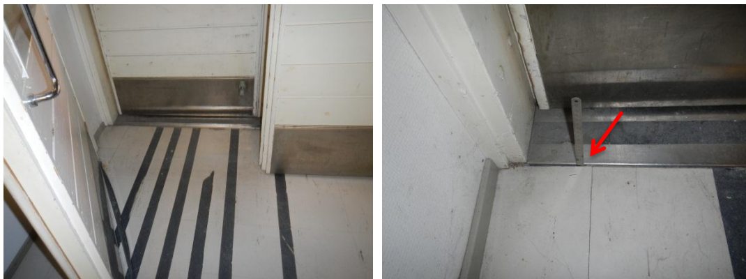
Kuva 7. 1. kerroksen toimistohuoneiden lattia-ulkoseinäliittymässä on pystyrako alas maatayttyöön. Kuvat huoneen 115 sisäänkäynnistä.
