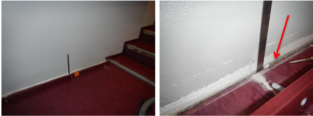
Kuva 11. Luentosali LS2: en lattia-ulkoseinäliittymässä on pystyrako alas maatayttyöön (Ra 1.3).
