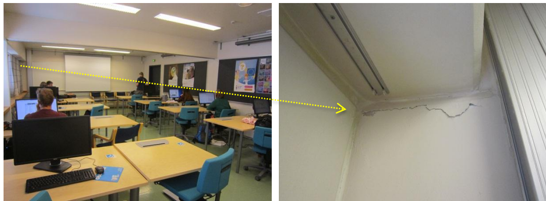
Kuva 37. Halkeama ulkoseinäpilarin ja -palkin liitoksessa 2. kerroksen ATK-luokan etuosassa.
