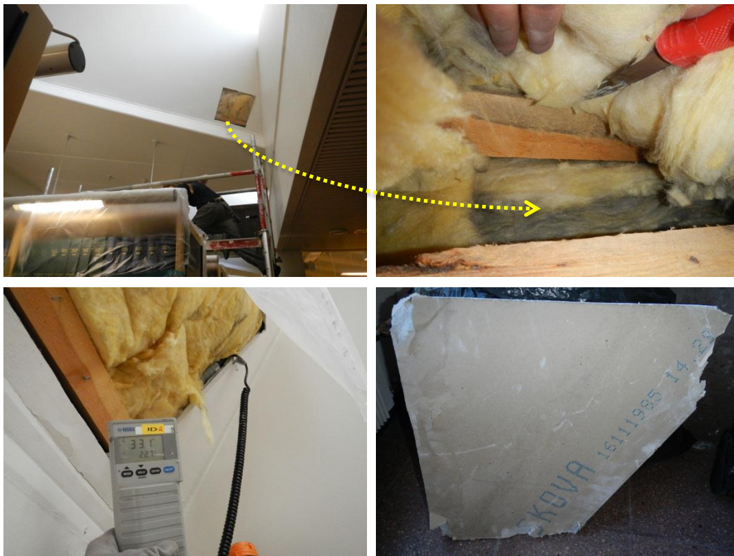
Kuva 61. Rakenneavaus Ra 2.3 eteläpuolimmaisen kattolyhdyn alanurkkaan. Puuosissa todettiin aistinvaraisesti arvioiden lievää homekasvua pinnalla. Eristevilloissa oli voimakasta tummentumaa. Rakenne oli tutkittaessa kuiva. Sisäkipsilevyssä todettiin vain lieviä kosteusjälkiä. Avauksesta kerätyissä materiaalinäytteissä (M11 ja M12, kipsilevyn takapintaa ja mineraalivillaa) todettiin mikrobikasvustoa.
