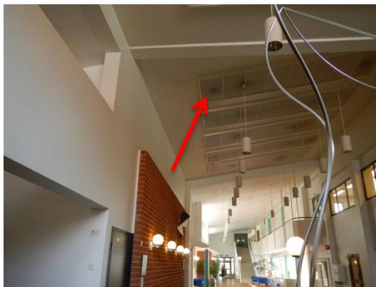
Kuva 67. Ilmavuotojälkeä akustolevyissä aulatilán katossa.
