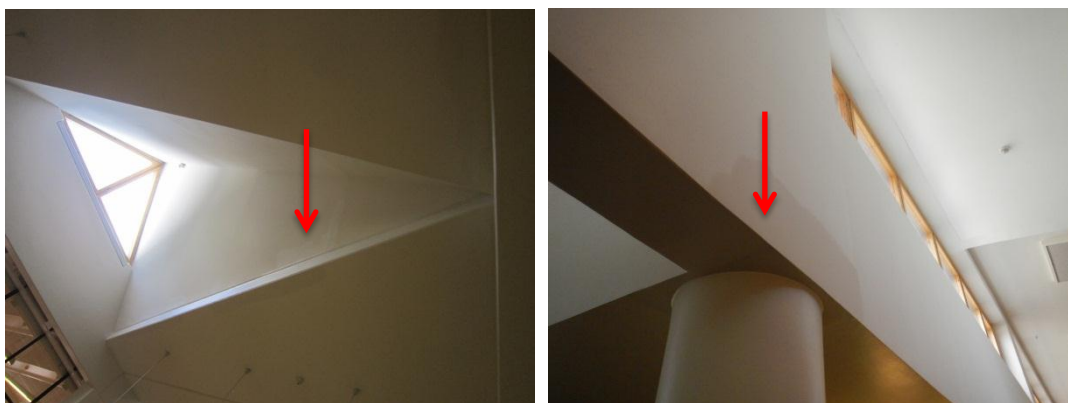
Kuva 58. Vuotovaurioiden korjaus-/pällemaalausjälkiä kirjastosalin ja aulan katossa.
