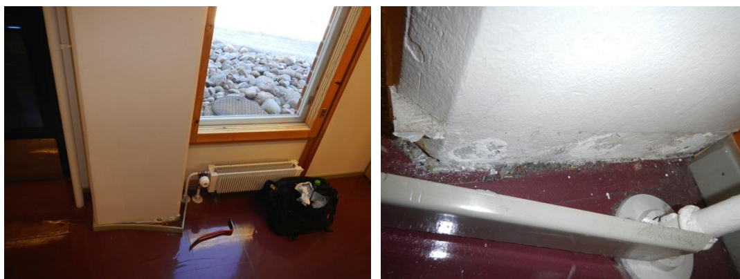
Kuva 34. Rakenneavaus Ra 1.6. Pilarin alaosassa oli havaittavissa lievää värinmuutosta ja tasoitteen irtoilua. Tasoitepinnasta kerättiin näyte mikrobianalyysiin (M4). Näytteessä ei todettu mikrobikasvua.
