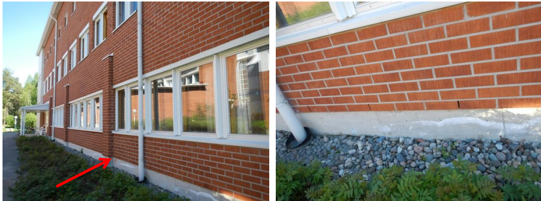
Kuva 19. Erityisesti länsipuolen julkisivulla oli sokkelien alaosien pinnoissa paikoin korkeampaan kosteusrasitukseen viittaavaa kalkkisuodosta.
