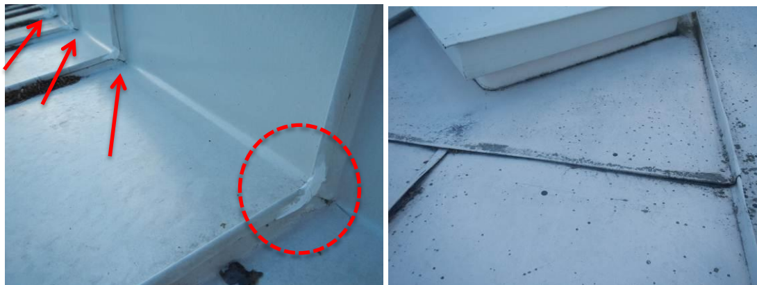
Kuvat 48 a ja b. Vasemmalla kuvassa ylösnosto, jossa sauman taitoskohdan reikää on kitattu massalla. Oikealla vesikate, joka on hieman likaantunut sauman kohdalta.
