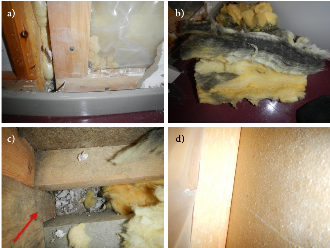
Kuva 32. Rakenneavaus Ra 1.5. Rakenteessa on höyrynsulkumuovi, joka on asennettu melko tiiviisti puurungon ja sisäpuolisen koolauksen väliin (a). Lämmöneristekerroksessa todettiin runsasta ilmavuotojälkeä (b). Rungon alaosassa oli havaittavissa kosteusrasituksen aiheuttamaa jälkeä (c). Seinärakenteen keskiosassa ei todettu poikkeamia (d). Sisäverhouslevy havaittiin aistinvaraisesti arvioiden hyväkuntoiseksi. Rakenteessa ei todettu normaalista poikkeavia hajuja. Eristevillan alapinnasta kerättiin materiaalinäyte (M3). Näytteessä ei todettu mikrobikasvua. Rakenteet todettiin piikkimittarilla ja aistinvaraisesti tarkasteltuna kuiviksi.
