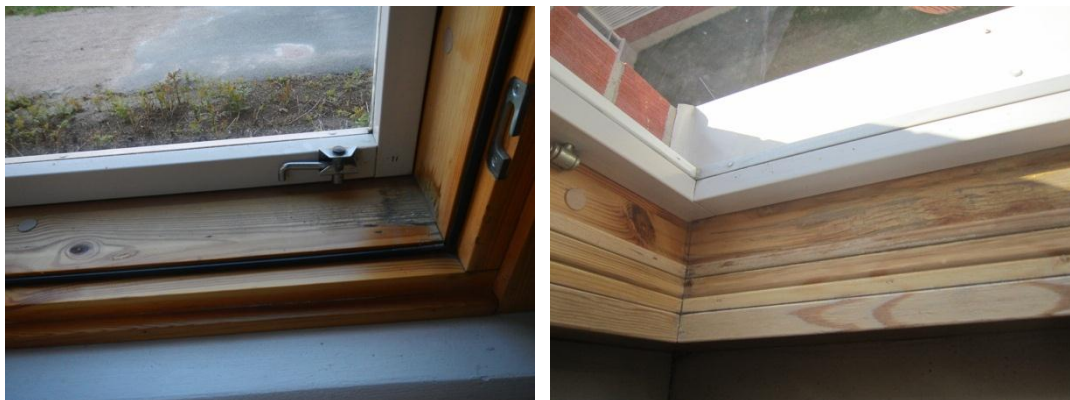
Kuva 26. B-siiven ikkunoissa oli paikoin pinnallisia kosteusvaurioita karmien ja puitteiden alapuissa.
