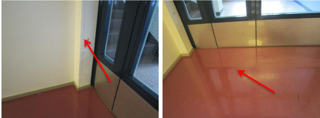
Kuva 43. Pohjoispäädyn rappukäytävän ovien edustalla on halkeama pilarin/koteloinnin kyljessä ja välipohjalaatassa.
