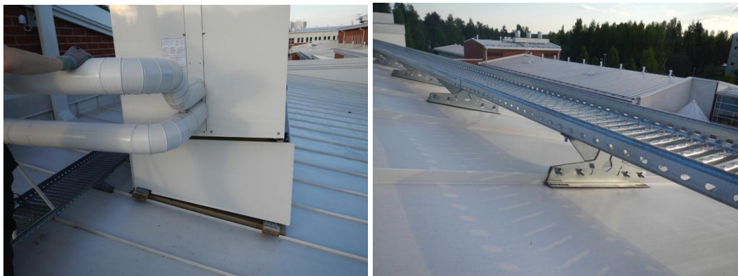
Kuva 56. Vasemmalla suoraan vesikatteen päälle asennettu jäähdytinkoneyksikkö. Oikealla kuvassa hyväkuntoiset kattoportaatt, jotka on kiinnitetty puristuskiinnikkeillä hakasaumoihin peltikatetta rikkomatta.
