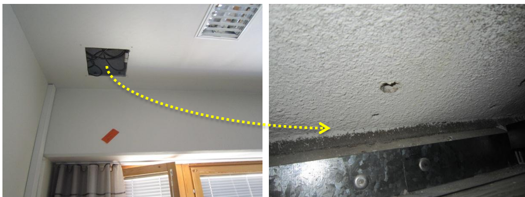
Kuva 62. ATK-luokka B220:n nurkan alakaton tarkastusluukku avattiin. Luukun kautta ei todettu vuoto/kosteusvauriojälkiä. Luukusta havaittiin kellertäviä valumajälkiä ontelolaattojen porausreikien ympärillä (rakennusaikaisia jälkiä).
