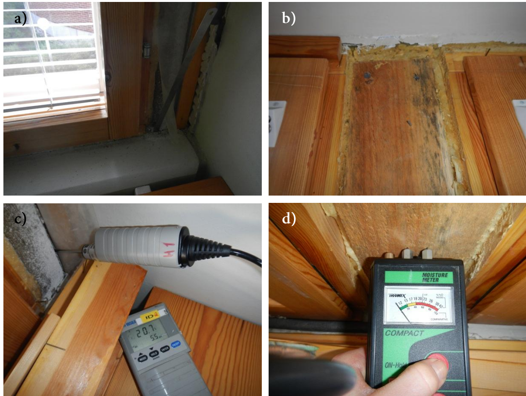
Kuva 35. Rakenneavaus Ra 2.1: 2. krs yläikkunat länteen, tila B214. Rakenteen höyrynsulku oli epätiiviisti asennettu (a), ja myös karmipuiden polyuretaanitiivistykset olivat paikoin epätiivit (c). Karmien sisäpinnoissa oli sinistymää (b), mutta rakenteet olivat muuten siistit ja kuivat (c, d). Ikkunan alanurkasta lämmöneristeestä ja karmipuun pinnasta kerättiin materiaalinäytteet mikrobianalyysiin (M9, M10). Näytteissä ei todettu mikrobikasvua.
