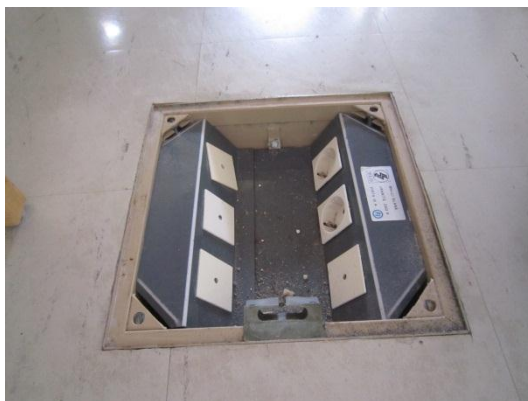
Kuva 44. Sähkökotelo huoneen 214 lattiassa.
