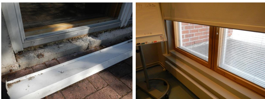
Kuva 28. Luentosalin LS3:n ikkunan rakenne tarkastettiin irrottamalla ikkunan vesipelti (Ra 1.4). Kuvat ulko- ja sisäpuolelta. Puukarmi on tiivistetty polyuretaanilla sokkelirakenteeseen. Rakenne oli sijaintiinsa nähden hyvässä kunnossa. Ikkunan alakarmi oli kovaa, vaurioitumattoman näköistä puuta. Rakenteeseen ajoittain pääsevä vesi valuu todennäköisesti styrox-täytteeseen syvään sokkelihalkaisuun. Sisälle LS3:n lattiaan ikkunan lähelle tehtiin rakenneavaus, josta ei todettu viitteitä rakenteiden vaurioista tai kosteusrasituksesta (ks. alapohjan havainnot edellä).
